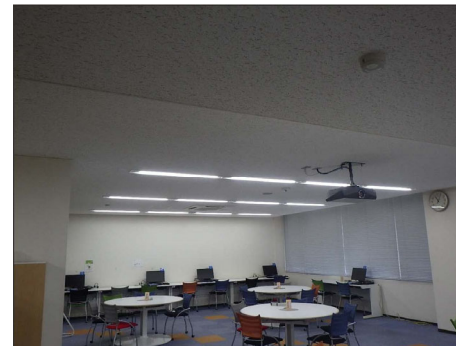
荒牧キャンパス メディアセンター ラーニングルーム LED照明へ更新
