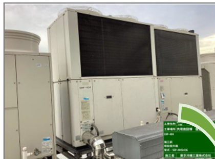
昭和キャンパス 空調設備
