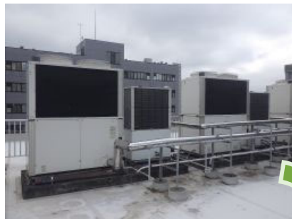
昭和キャンパス 空調設備
