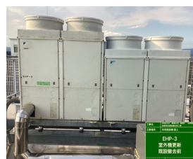
昭和地区 実験室等の空調機更新前
