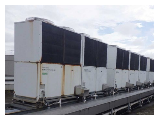
昭和地区 附属病院 診療棟の空調機更新前
