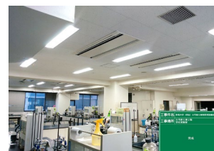
桐生地区 実験室 LED照明への更新後
