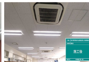
若宮地区 附属学校校舎 職員室 LED照明への更新後
