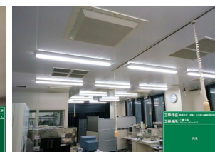
桐生地区 クリーンルーム LED照明への更新後
