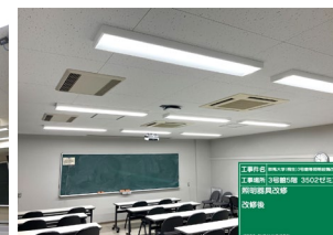
桐生地区 ゼミ室 LED照明への更新後
