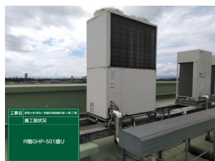
荒牧地区 実験室等の空調機更新前
