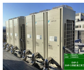
昭和地区 実験室等の空調機更新後
