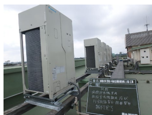
荒牧地区 実験室等の空調機更新後
