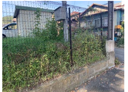
敷地境界フェンス(ツタ放置)
