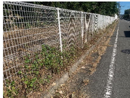
敷地境界フェンス(ツタ放置)
