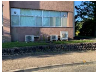
地上設置の空調室外機①
