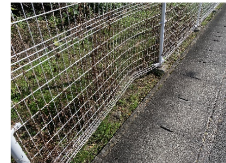
敷地境界フェンス(凹み放置)
