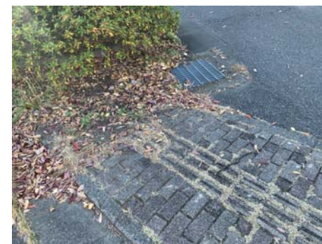
点字ブロックの劣化
