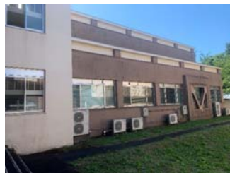
地上設置の空調室外機②
