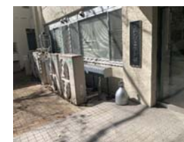
地上設置の空調室外機③
