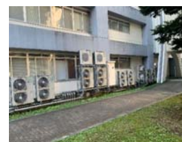
地上設置の空調室外機①
