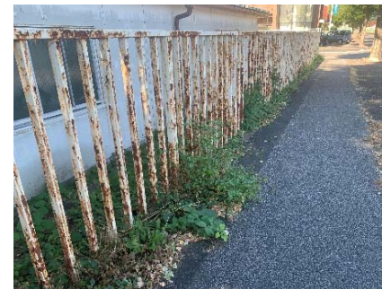
敷地境界フェンス(塗装剥がれ)
