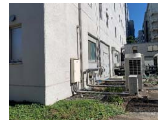
地上設置の空調室外機
