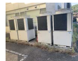
地上設置の空調室外機②
