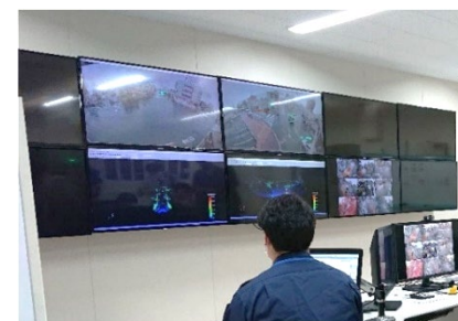
管制室(CRANTS内)
