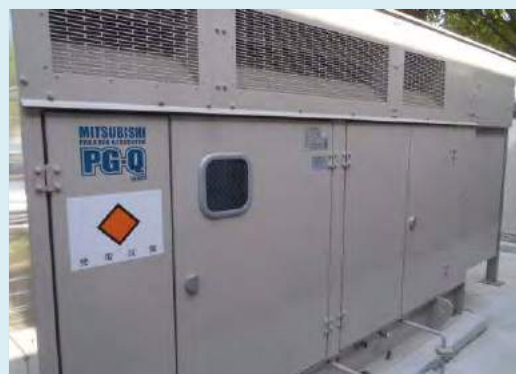
◇◇整備した非常用発電設備◇◇
