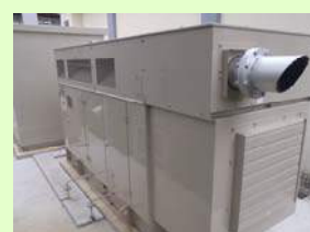
非常用発電機 (200 kW)
