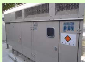
非常用発電機 (200 kW)
