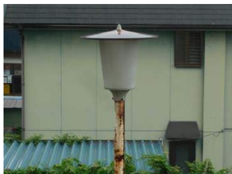
更新前の外灯 （水銀灯：消費電力400W）
