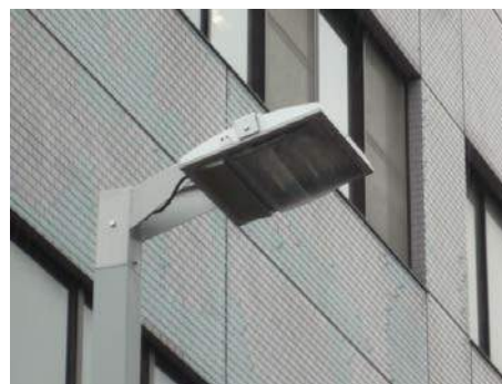
更新後の外灯 （LED照明：消費電力186W）
