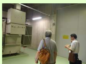
非常用発電機 (2,000 kW)
